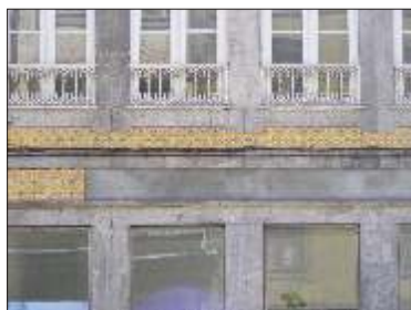
Pela falta de azulejos em número suficiente, foi preconizado o preenchimento da área em falta com argamassa de cimento.
