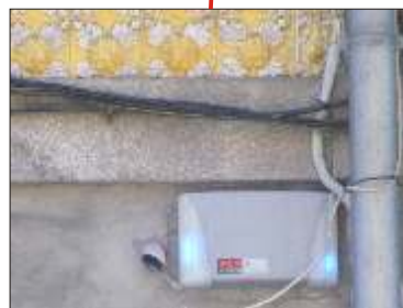
Pouco cuidado nos acabamentos da obra: excesso de cablagens à vista e com fixação deficiente.
