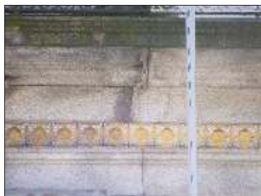
Colonização biológica na varanda, incrementada pela lavagem da pedra com jacto de água a alta pressão.
