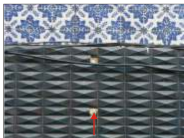
Fissura estrutural, com fractura e destacamento de azulejos.
