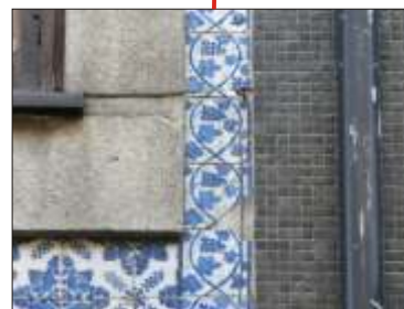
Lacuna no azulejo de friso certamente motivada por falta de cuidado durante a construção do prédio adjacente.
