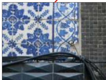
Danos provocados pela fixação de cablagens.
