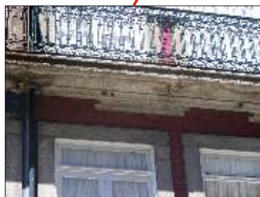
Queda de azulejos certamente por acção de humidade.
